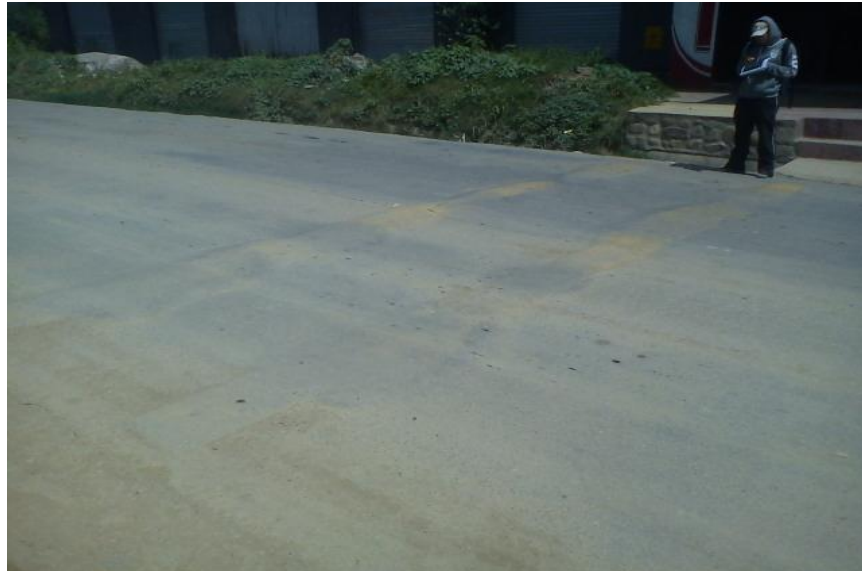
Fotografía 3.- Reductores de velocidad con demarcaciones gastadas
