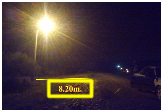
Fotografía 16.- Luminaria alejada de la calzada
