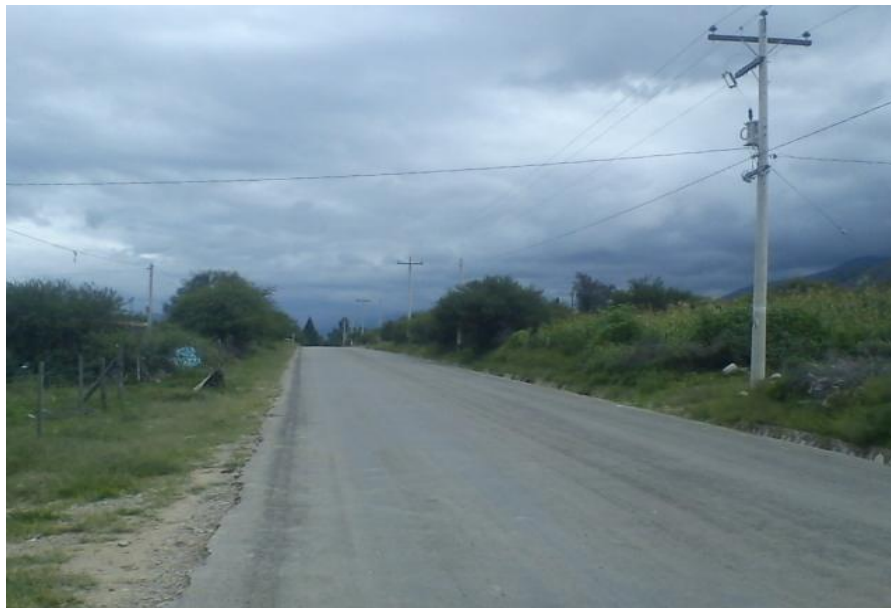
Fotografía 4.- Vía deteriorada sin señalización
