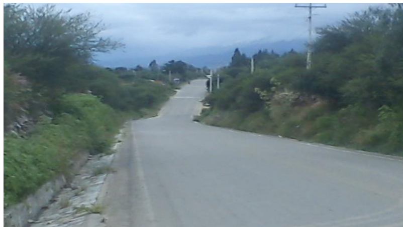
Fotografía 2.- Vía sin mantenimiento
