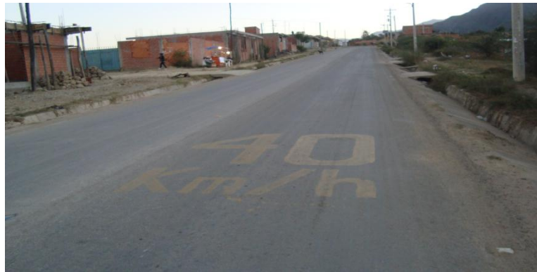
Fotografía 6.- Señales sin retroreflectancia
