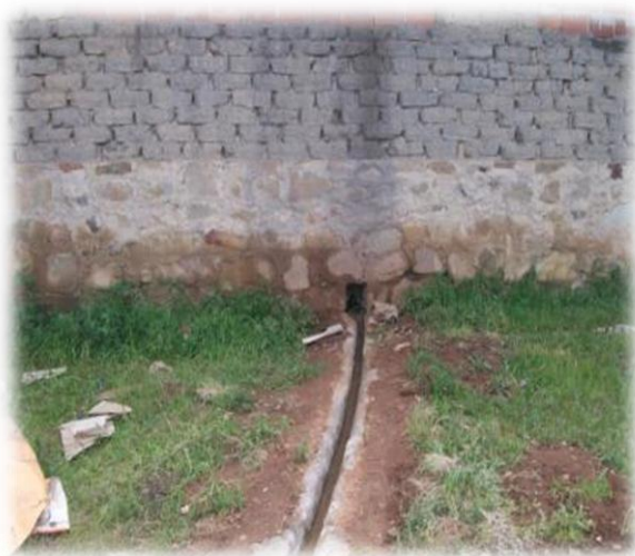
FOT.8 Descarga de agua laboratorio directo a terreno
