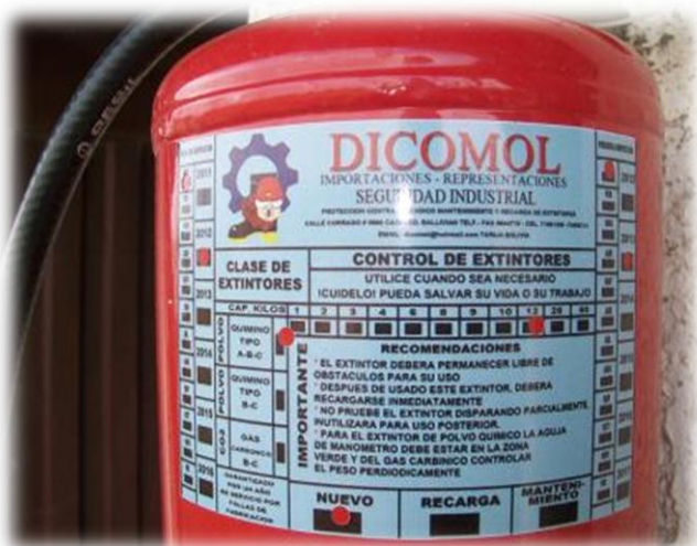
FOT.11 Los extintores requieren de recarga debido a que ya venció el periodo establecido para inspección
