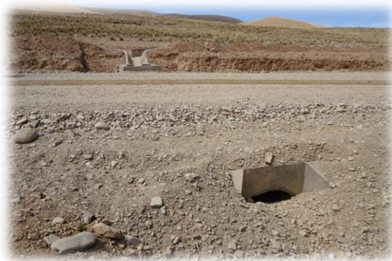
FOT.2 Diferentes alcantarillas que se encuentran obstruidas por material de relleno
