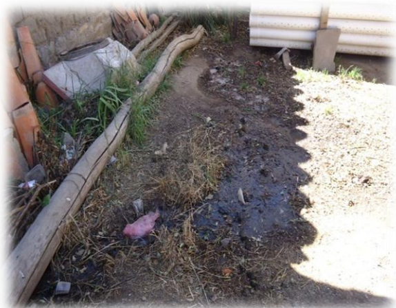
FOT.3 Fuga de aguas grises proveniente del baño de la maestranza
