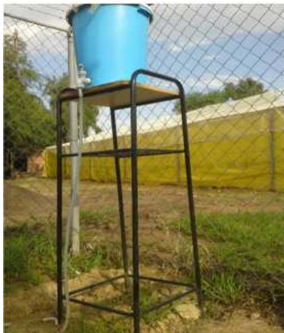
Foto 4.10.- Tanque de abastecimiento instalado
