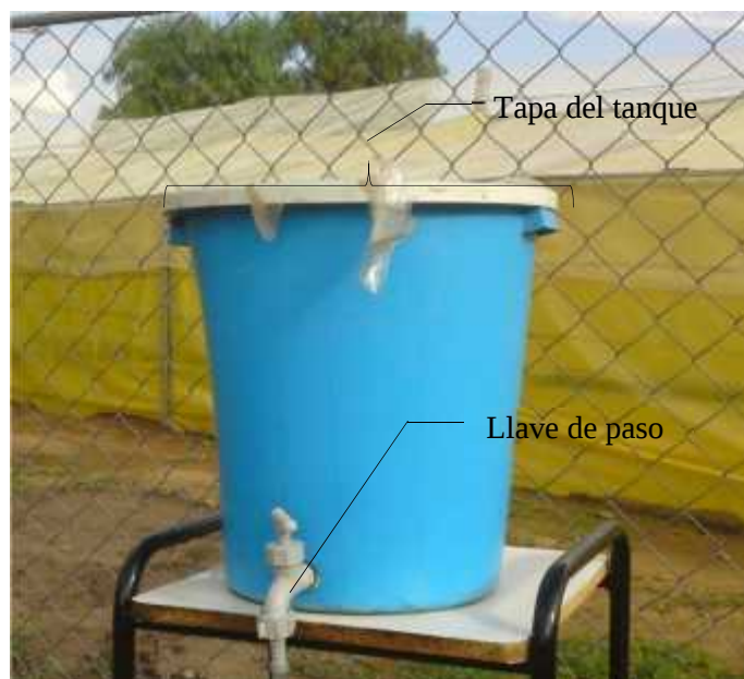
Foto 3.6.- Tanque de abastecimiento
