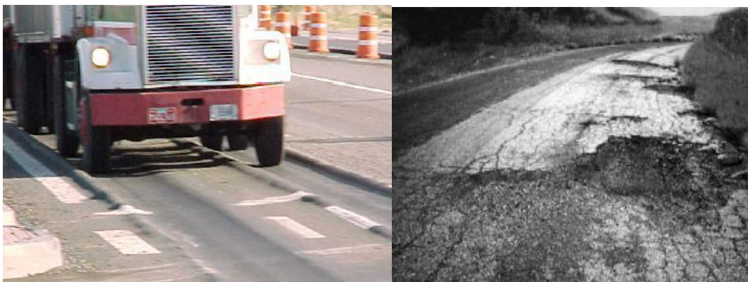
Figura 9: Efectos De La Sobre Carga Vehicular Sobre El Pavimento
