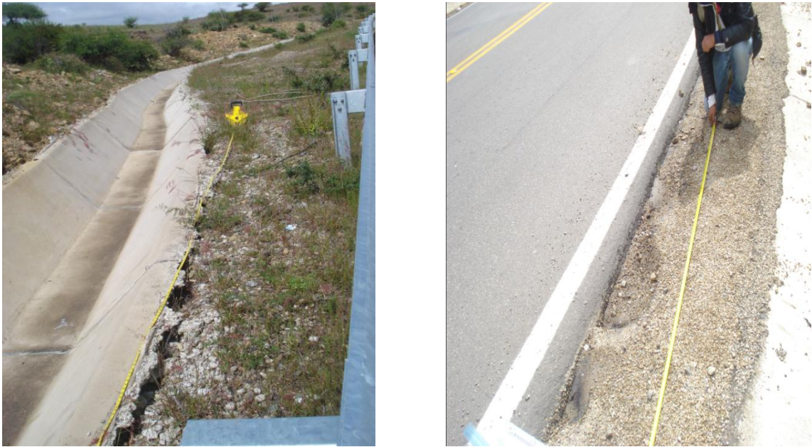
Foto 4.3.1 Fallas generales en juntas
