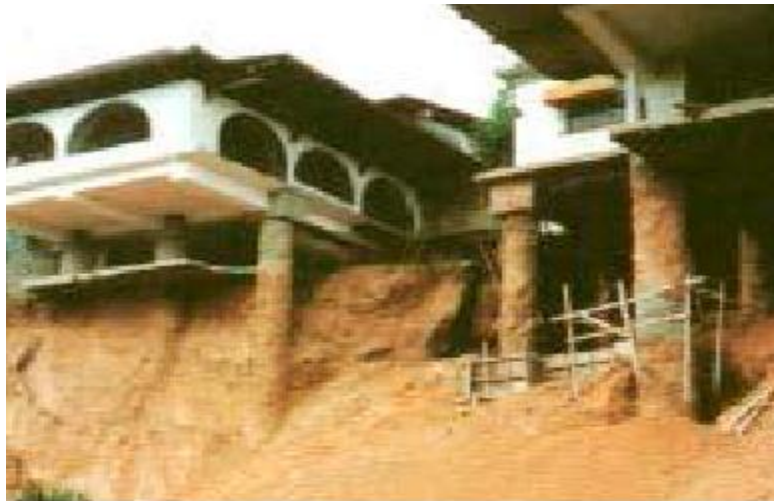
Figura 3. Pilotes expuestos debido a la no consolidación del terreno 3
