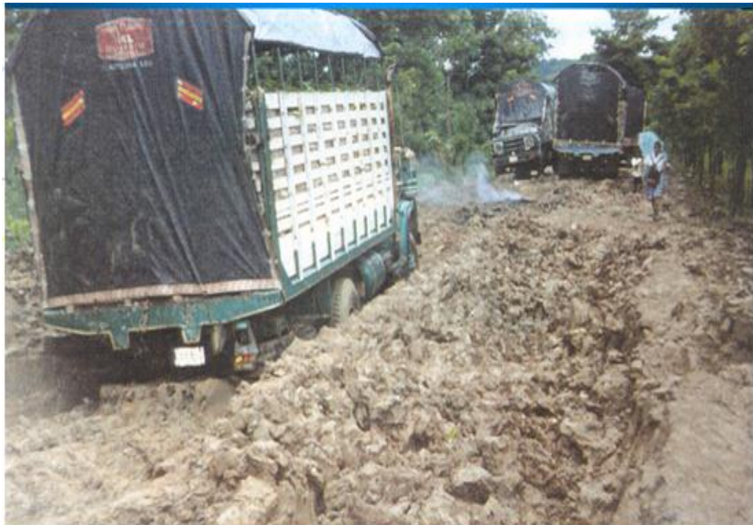
Ilustración 2. Subrasante deteriorada por la humedad.
