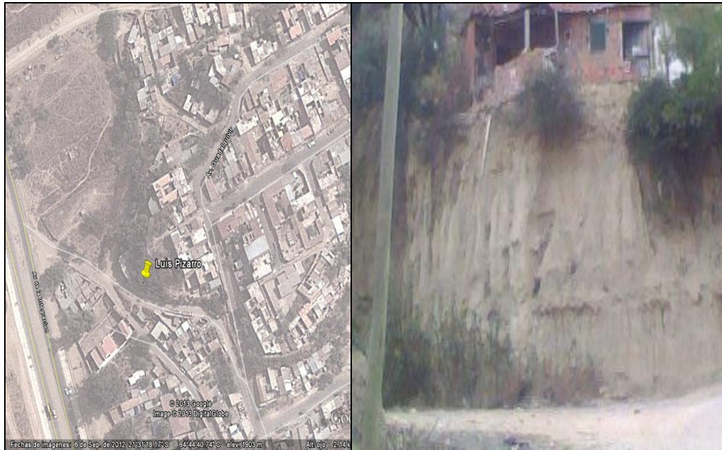
FOTOGRAFÍA III- 6 TALUD BARRIO LUIS PIZARRO
