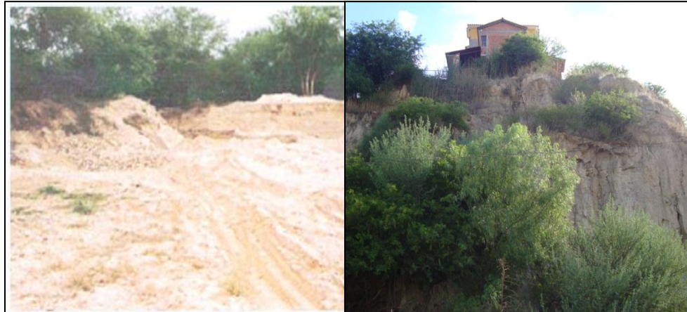
FOTOGRAFÍA III – 10 CORONA DEL TALUD AV. LOS SAUCES (B/SAN MARTÍN)
