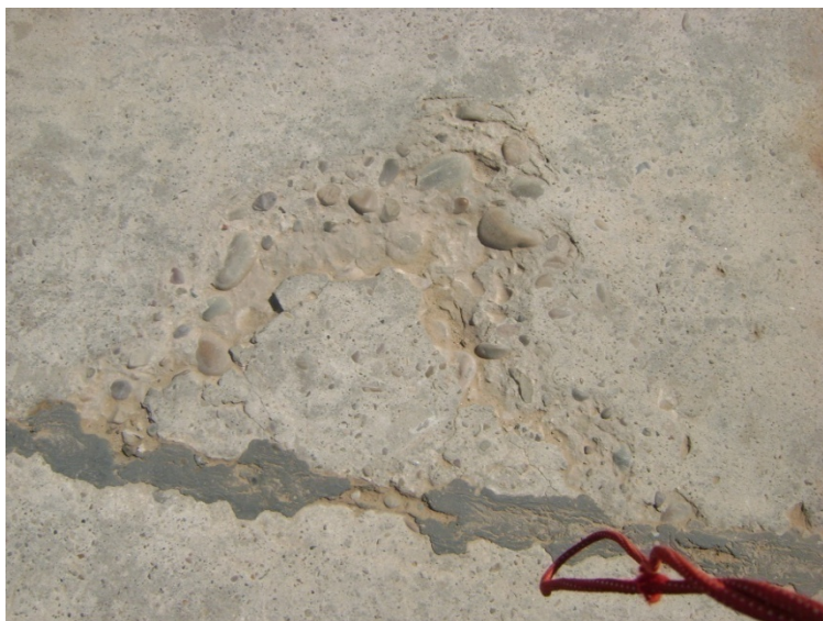
Fig. 4.19 Fisura por mal Funcionamiento de Juntas
