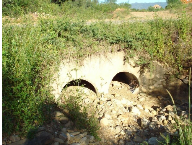
Fotografía 2.2. Embanque de alcantarilla.
