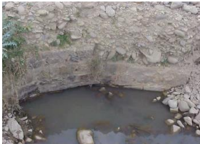
Fotografía 2.1. Sección insuficiente del conducto.
