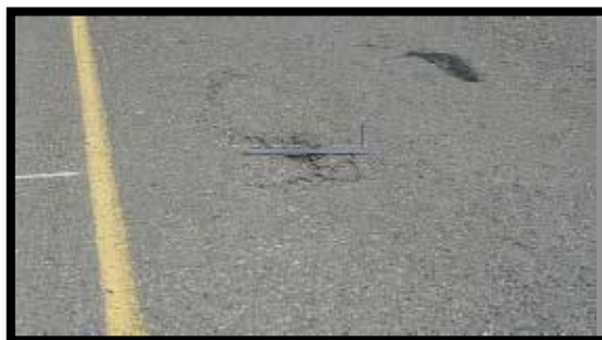
FIGURA 33 Huecos severidad baja
