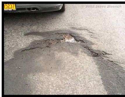
FIGURA 45 Grietas de deslizamiento severidad alta
