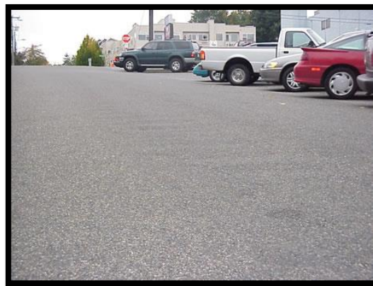
FIGURA 14 Corrugaciones severidad baja
