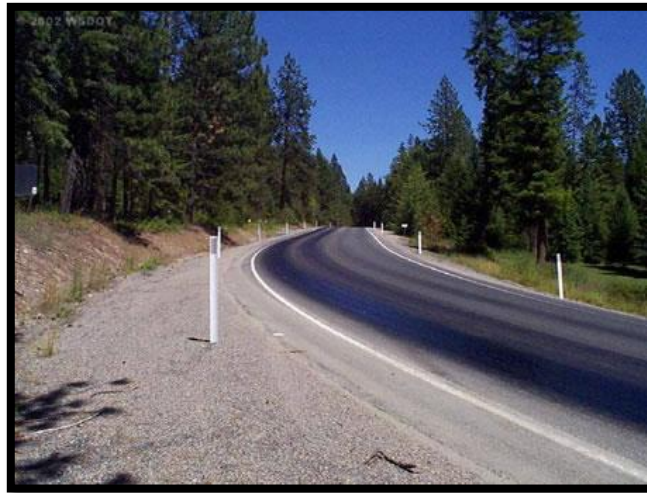
FIGURA 8 Exudación de asfalto severidad alta
