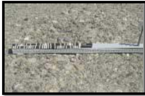
FIGURA 49 Disgregación y desintegración severidad alta
