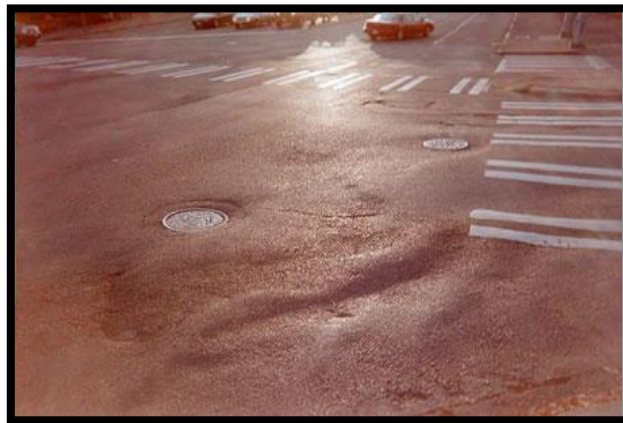
FIGURA 43 Deformación por empuje severidad alta
