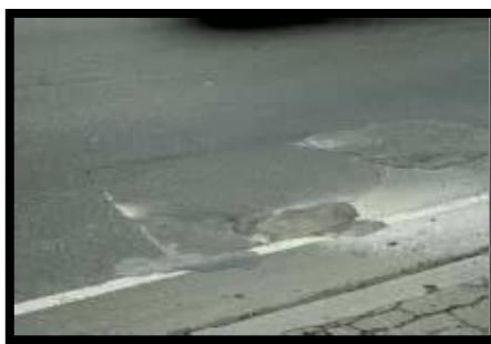
FIGURA 31 Baches y zanjas reparadas severidad baja
