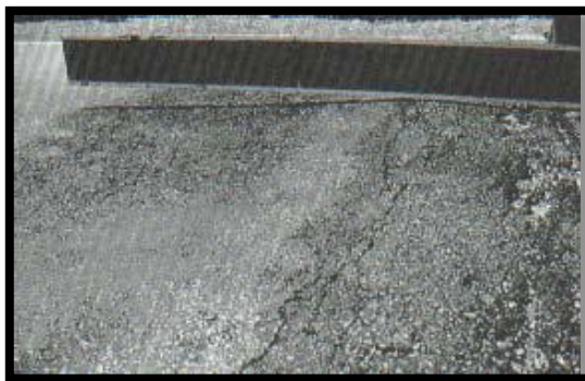
FIGURA 13 Elevación - hundimiento severidad alta
