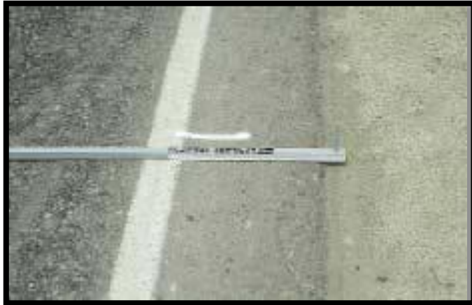
FIGURA 24 Desnivel calzada severidad media
