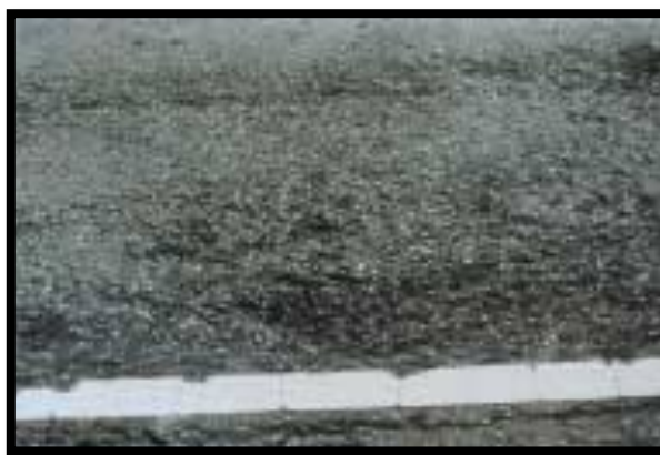
FIGURA 48 Disgregación y desintegración severidad media
