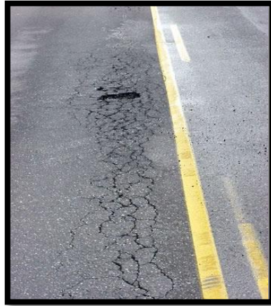
FIGURA 5 Grieta piel de cocodrilo severidad alta
