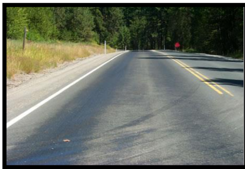
FIGURA 6 Exudación de asfalto severidad baja
