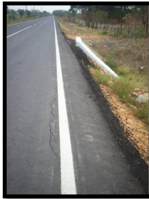
FIGURA 19 Grietas de borde severidad baja
