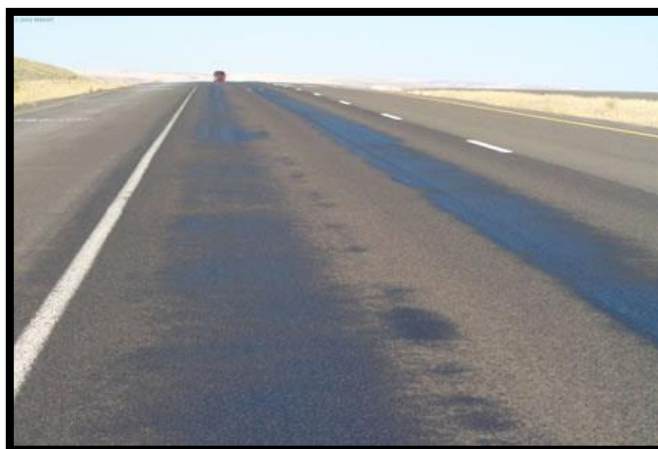
FIGURA 7 Exudación de asfalto severidad media
