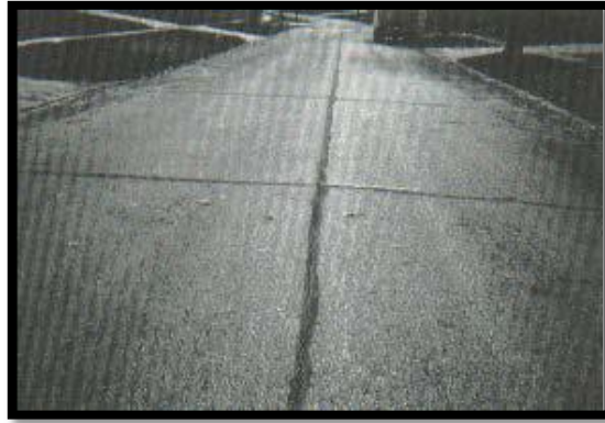
FIGURA 22 Grietas de reflexión de junta severidad baja
