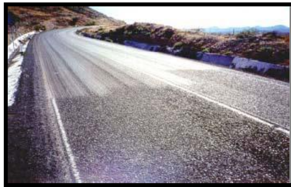
FIGURA 47 Disgregación y desintegración severidad baja
