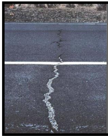
FIGURA 28 Grietas longitudinales y transversales severidad alta
