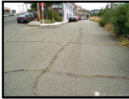
FIGURA 23 Grietas de reflexión de junta severidad alta
