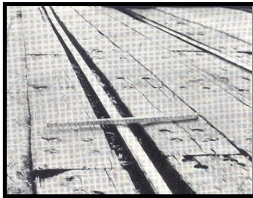
FIGURA 37 Cruce de rieles, por accesos a puentes y rejillas de drenaje severidad media
