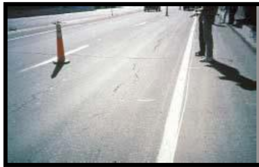
FIGURA 3 Grieta piel de cocodrilo severidad baja
