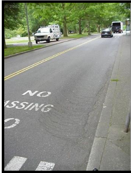
FIGURA 44 Grietas de deslizamiento severidad baja
