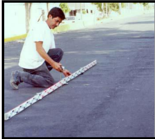
FIGURA 15 Corrugaciones severidad media
