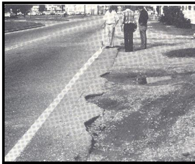
FIGURA 21 Grietas de borde severidad alta
