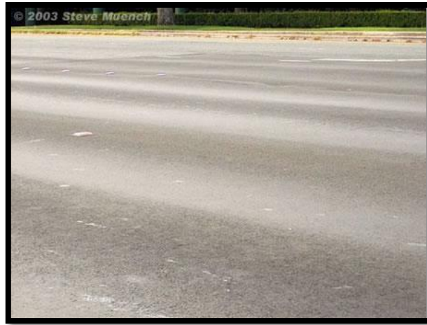
FIGURA 40 Ahuellamiento severidad media
