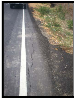
FIGURA 20 Grietas de borde severidad media
