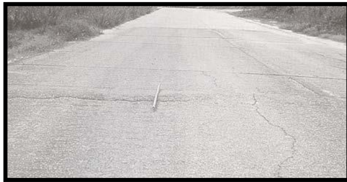
FIGURA 46 Hinchamiento severidad media
