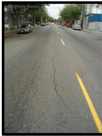
FIGURA 26 Grietas longitudinales y transversales severidad baja
