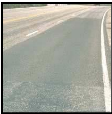
FIGURA 29 Baches y zanjas reparadas severidad baja
