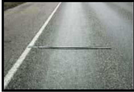
FIGURA 39 Ahuellamiento severidad baja
