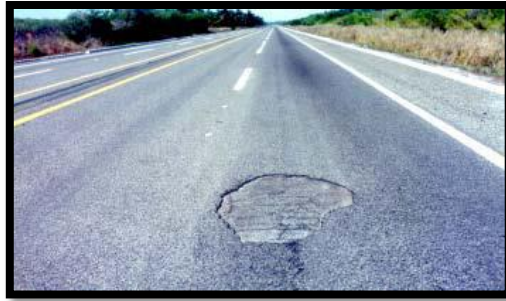
FIGURA 34 Huecos severidad media
