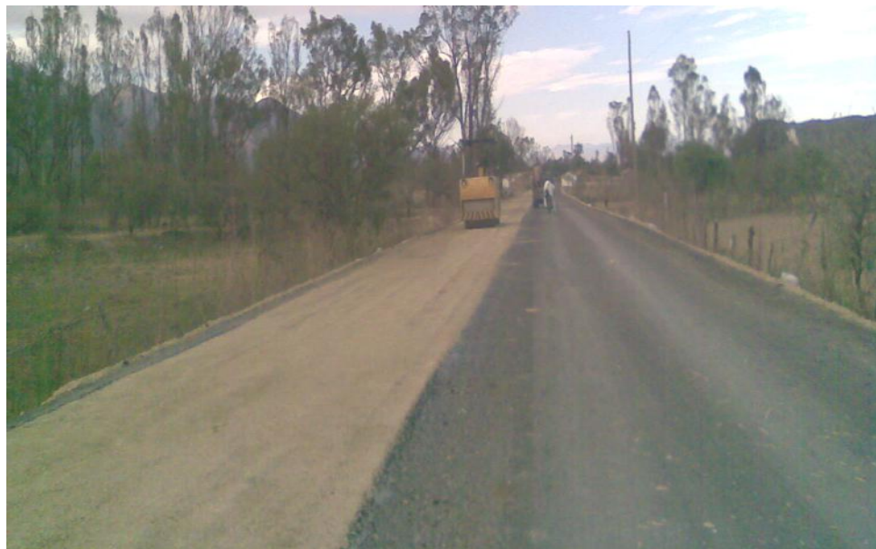
Figura N° 3.6 Problemas De Compactación De La Sub Base
