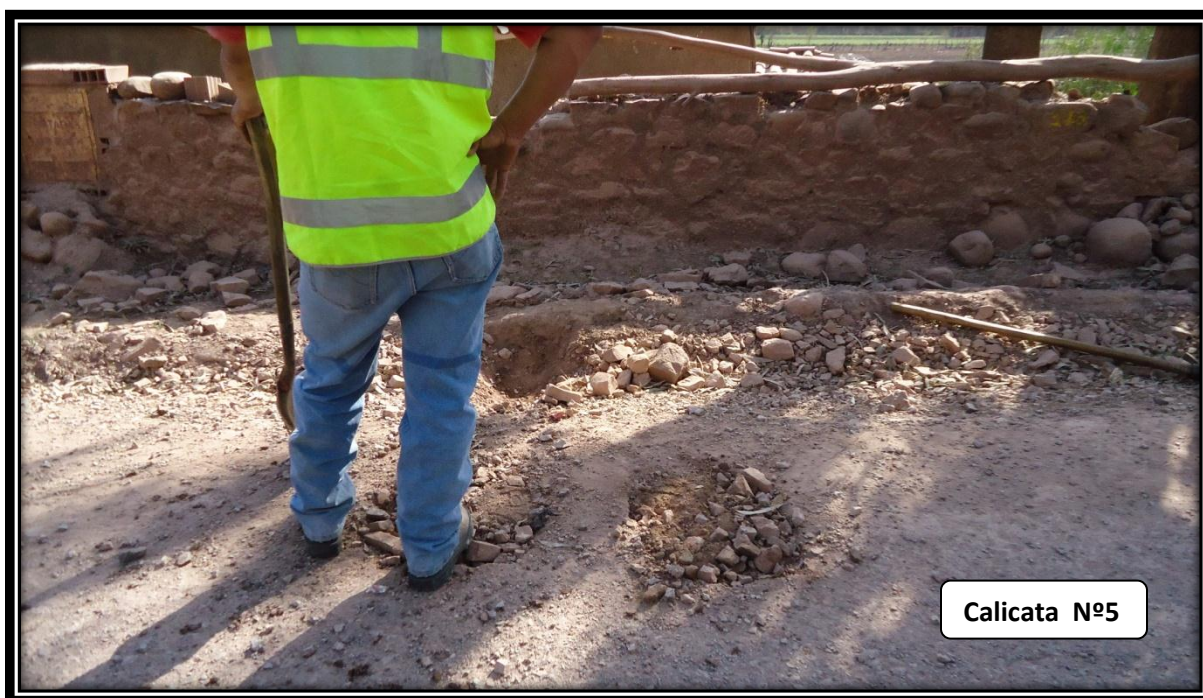
Figura 4.6. Progresiva 0+2000, lado derecho del camino.
