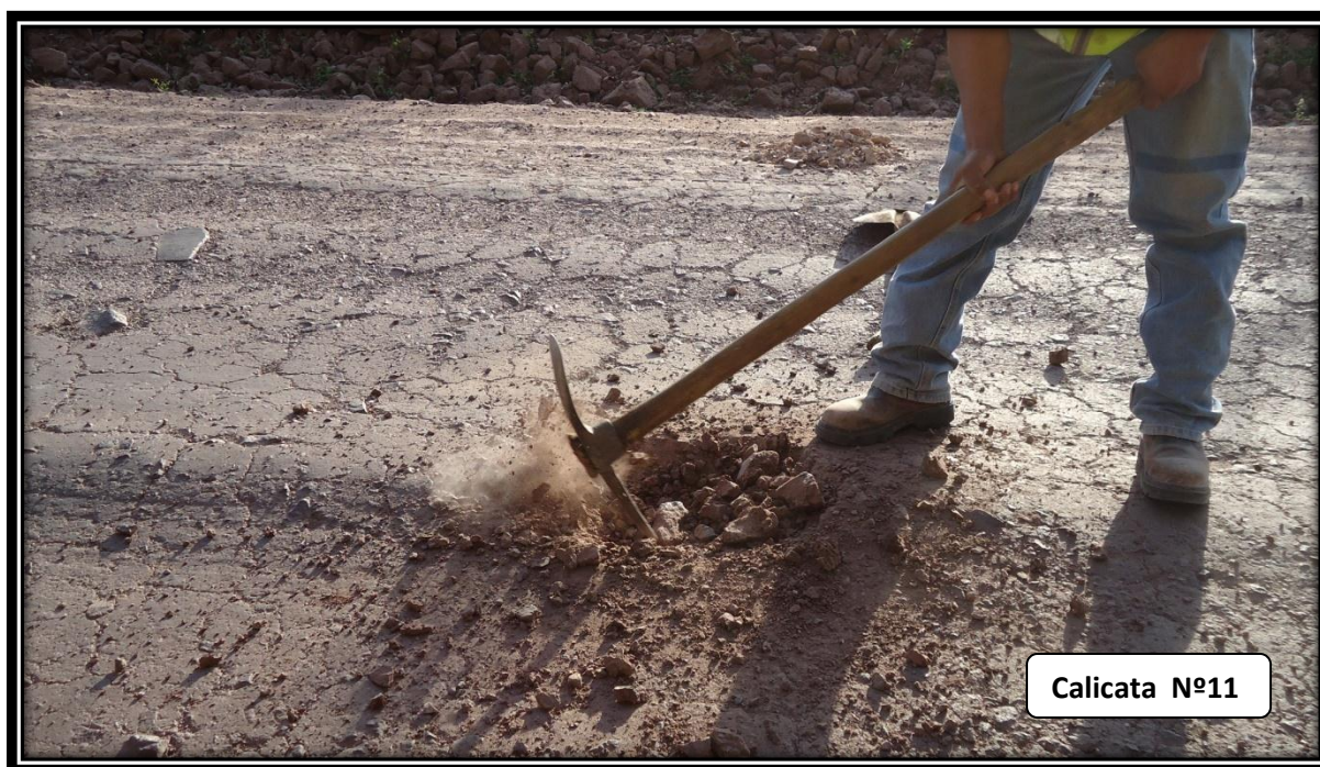
Figura 4.12. Progresiva 0+5000, lado derecho del camino.
