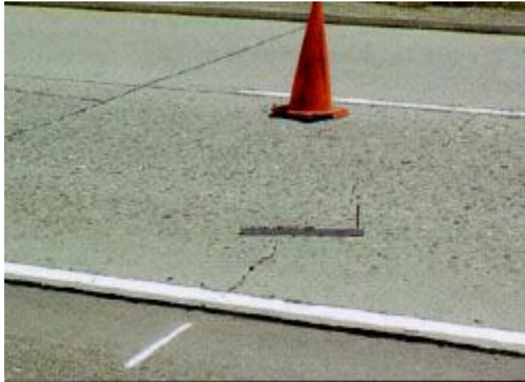
Fotografía 9. Fisuras por Transversales y Diagonales
