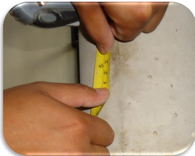
Fotografía 50. Medición de Longitud de Fisura
