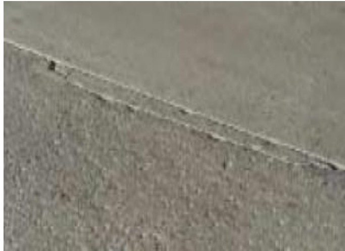
Fotografía 16. Fisuras por Mal Funcionamiento de Juntas
