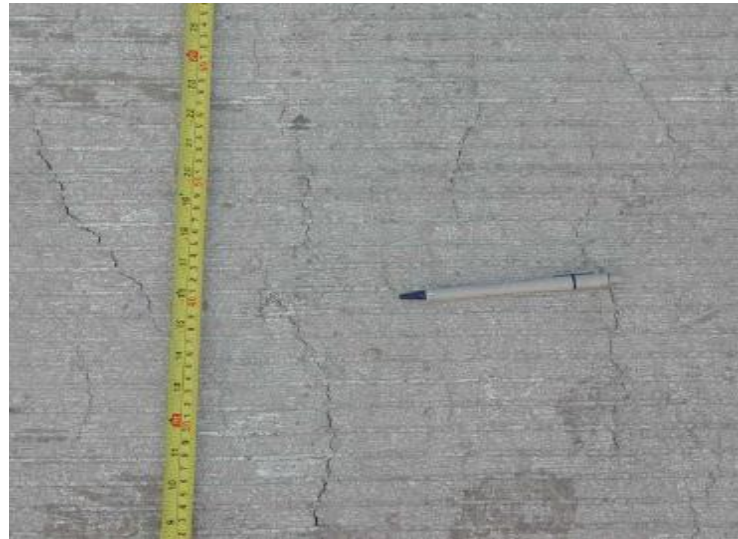
Fotografía 8. Fisuras por Contracción Plástico
