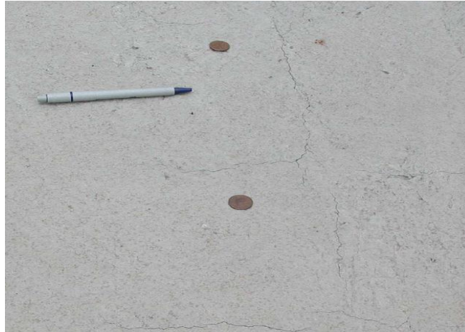
Fotografía 7. Fisuras por Asentamiento Plástico
