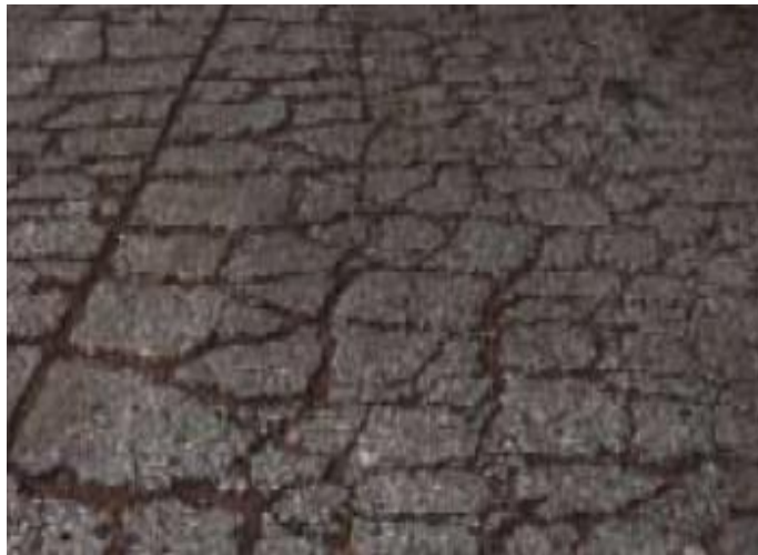
Fotografía 12. Fisuras de Losas Subdivididas
