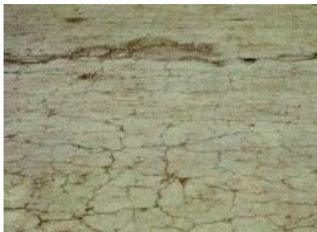
Fotografía 13. Fisuras en Bloque
