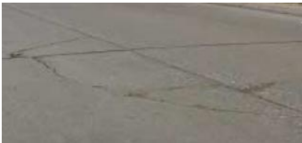
Fig.3.3. Fisura De Esquina
