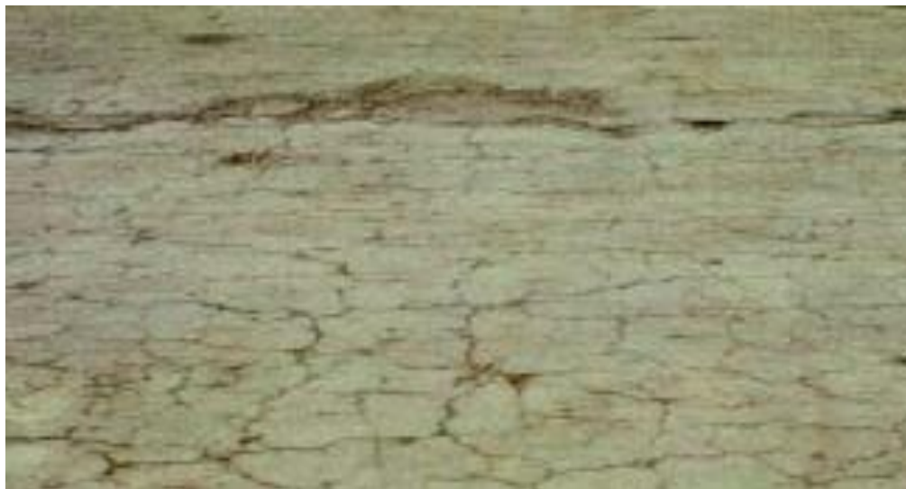
Fig.3.5. Fisuras en Bloque
