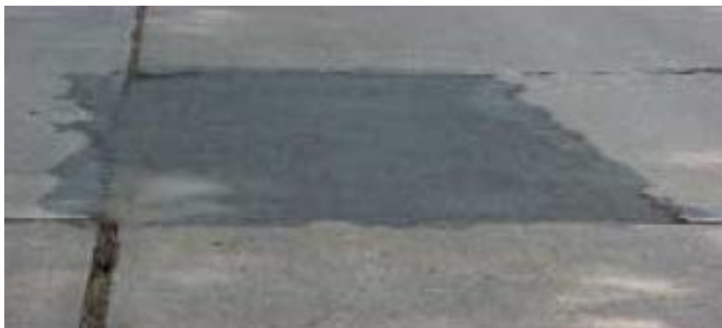
Fig.3.17. Parchados y reparaciones para servicios públicos
