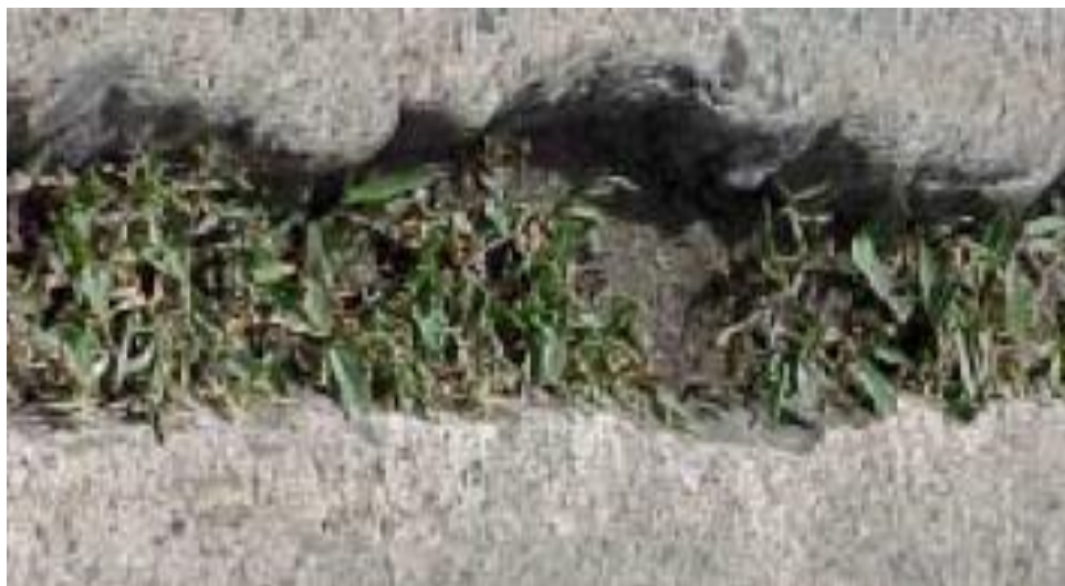
Fig.3.14. Deficiencias en material de Sello
