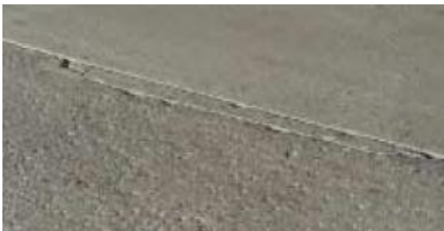
Fig.3.16. Fisura por mal Funcionamiento de Juntas
