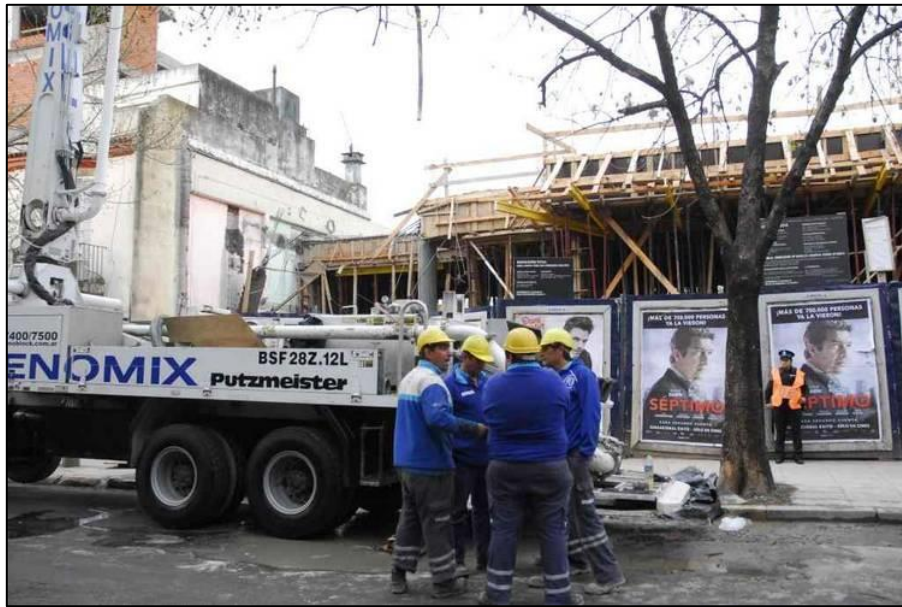
Fig.1.5 Derrumbe en edificio en construcción en Villa Devoto Buenos Aires, Argentina (Fuente: elclarin.com)
