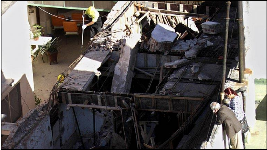
Fig.1.3 Derrumbe en edificio en construcción en Caballito, Buenos Aires Argentina (Fuente: infobae.com)
