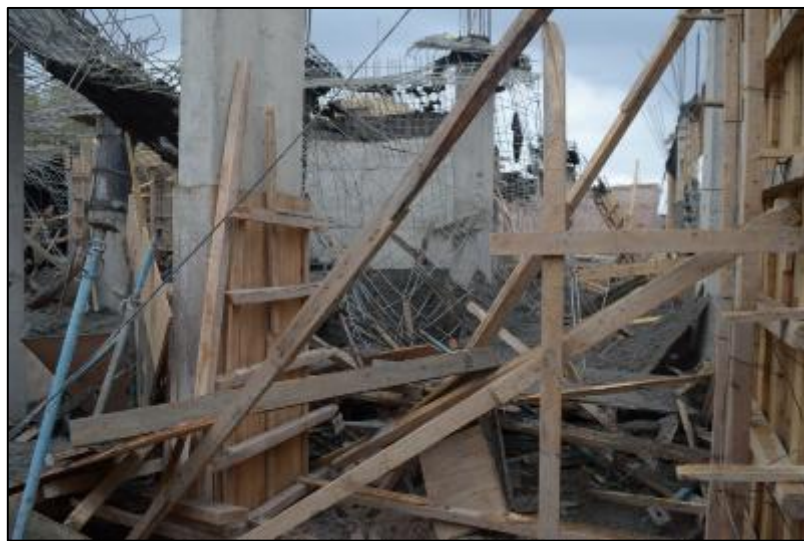
Fig.1.4 Derrumbe en edificio en construcción en Villa Regina, Río Negro Argentina (Fuente: rionegro.com.ar )
