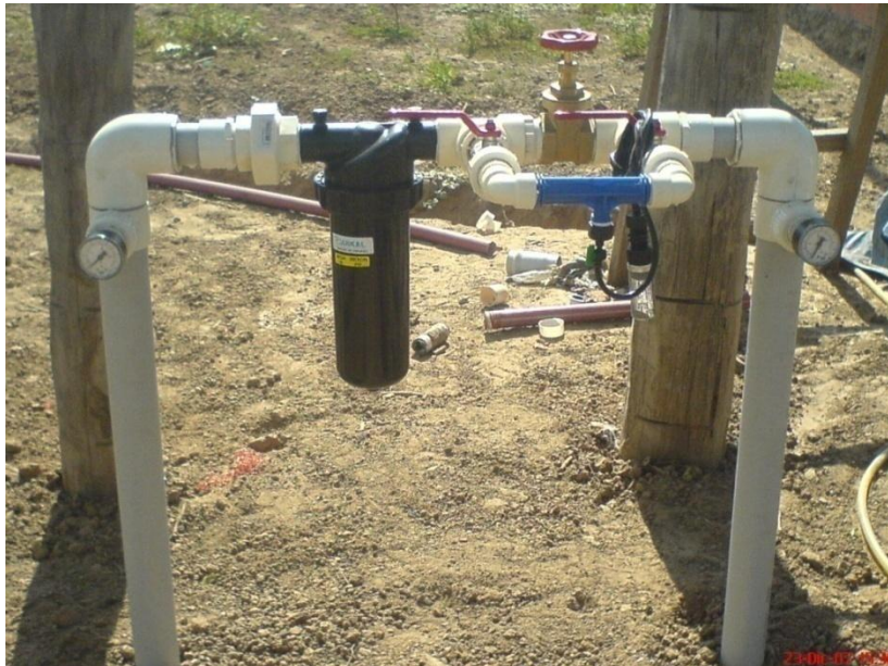
FIGURA N° 3.22 Controlador de la unidad de riego
