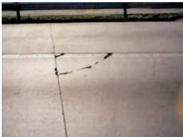
Figura 12: Grieta de esquina en pavimento rígido. Fuente: Sellado de juntas y grietas, correcta aplicación y evolución en Latinoamérica. Pavimentos T 004.
