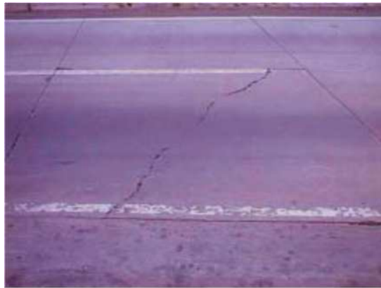
Figura 13: Grieta de transversal en pavimento rígido. Fuente: Sellado de juntas y grietas, correcta aplicación y evolución en Latinoamérica. Pavimentos T 004.
