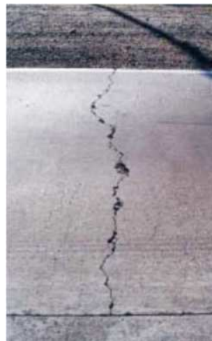
Figura 14: Grieta de transversal. Fuente: Sellado de juntas y grietas, correcta aplicación y evolución en Latinoamérica. Pavimentos T 004.
