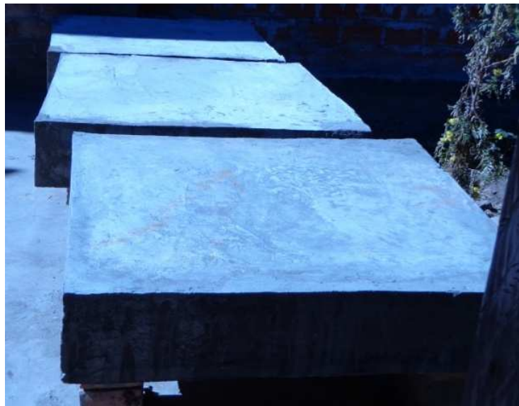
Figura 59: Levantado de la losas en apoyos.
