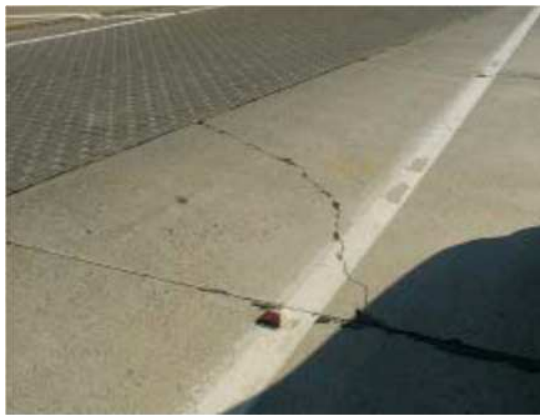
Figura 11: Grieta de esquina. Fuente: Sellado de juntas y grietas, correcta aplicación y evolución en Latinoamérica. Pavimentos T 004.
