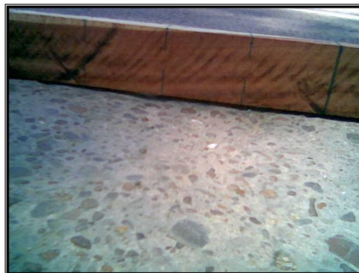
Deformación en el pavimento Rígido
