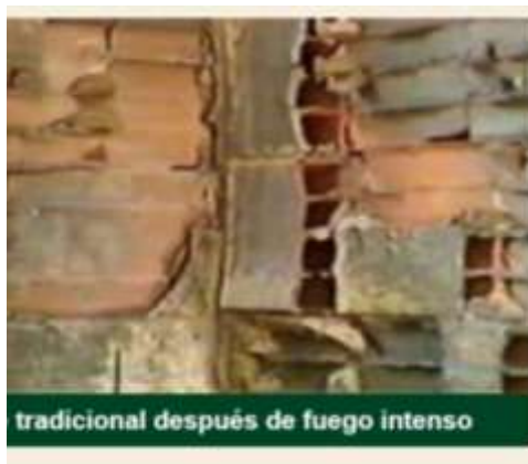
Ladrillo tradicional después de fuego
