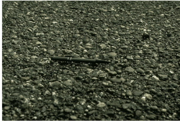
Figura No. 2.26 Desprendimiento por problemas de adhesividad asfalto/agregado
