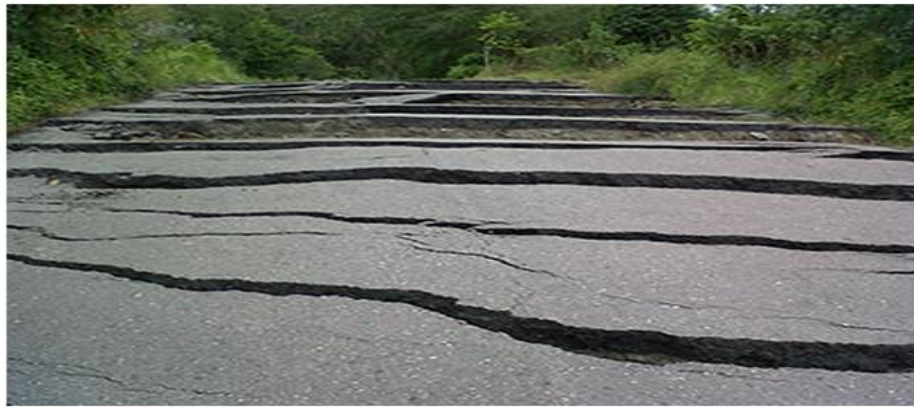
Figura N° 2.7. Tira asfáltica afectada por suelos expansivos.
