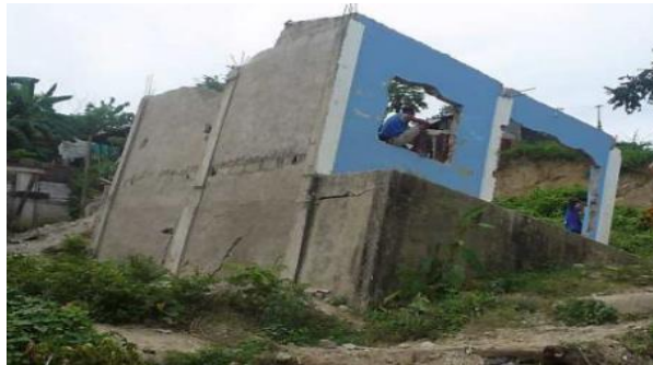
Figura N° 2.8. Hundimientos irregulares por la presencia de arcillas expansivas.
